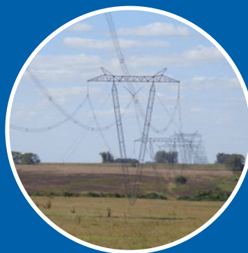
Línea de Transmisión 500 kV (Fuente: UTE)
